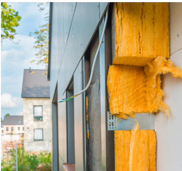
Hinterlüftete Fassade mit Mineralwolldämmung.
