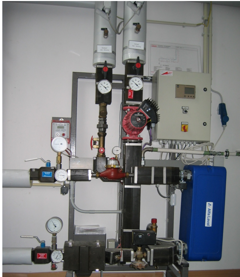
Max. 3 Regelkreise (z.B. 2 x Heizung, 1 x TWE) Wärmelieferung nach Hausparameter
