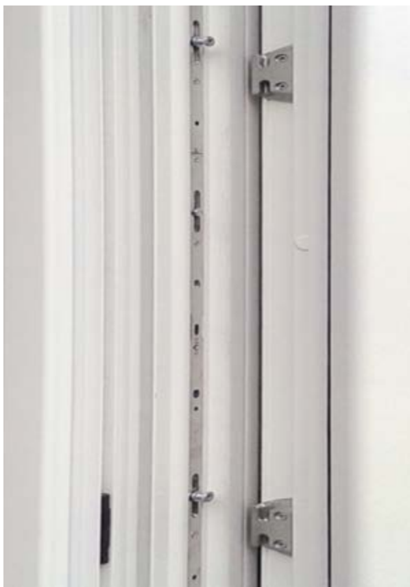
Eine Pilzkopfverriegelung sichert das Fenster zusätzlich.
