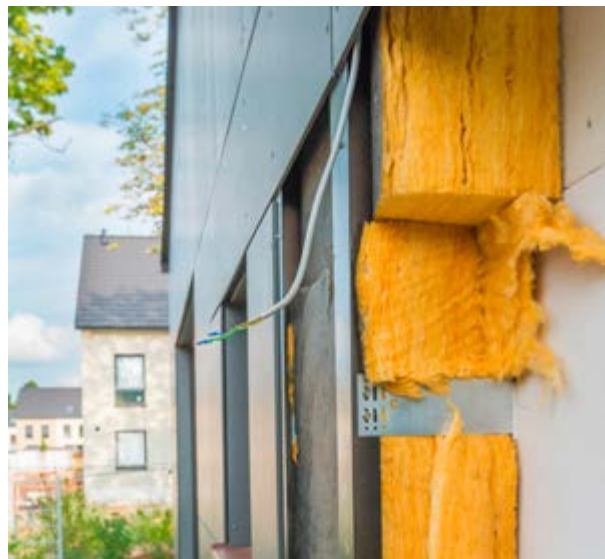
Hinterlüftete Fassade mit Mineralwolldämmung.
