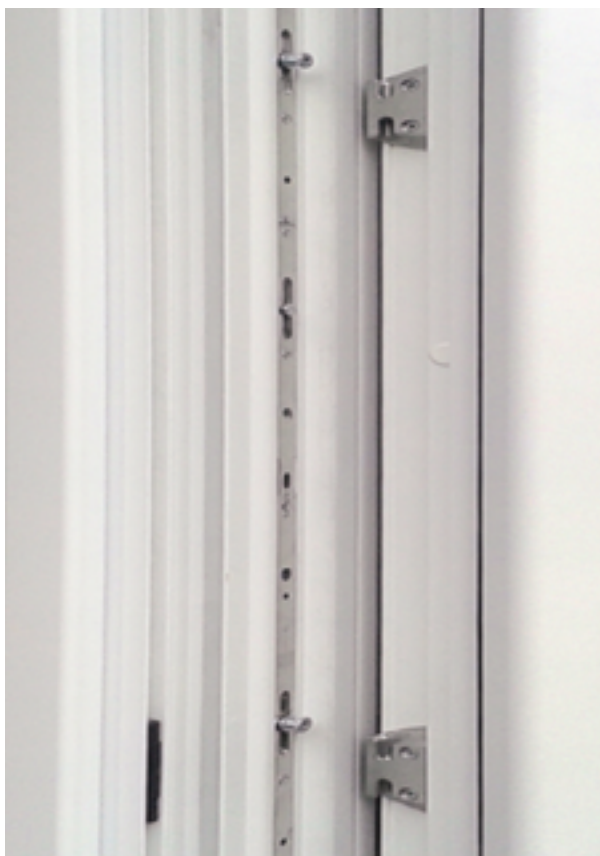
Eine Pilzkopfverriegelung sichert das Fenster zusätzlich.
